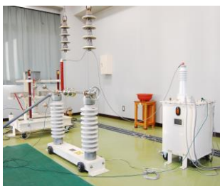
高電圧実習室
